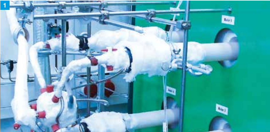
1 Rohre aus DEGUSSIT AL23 mit angeschlossener Analytik
